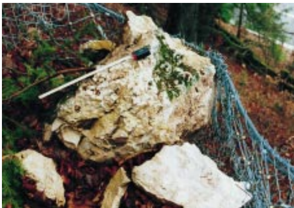
Abb. 43: Abgestürzte Felsblöcke im Schutznetz oberhalb L 277 im Donautal
